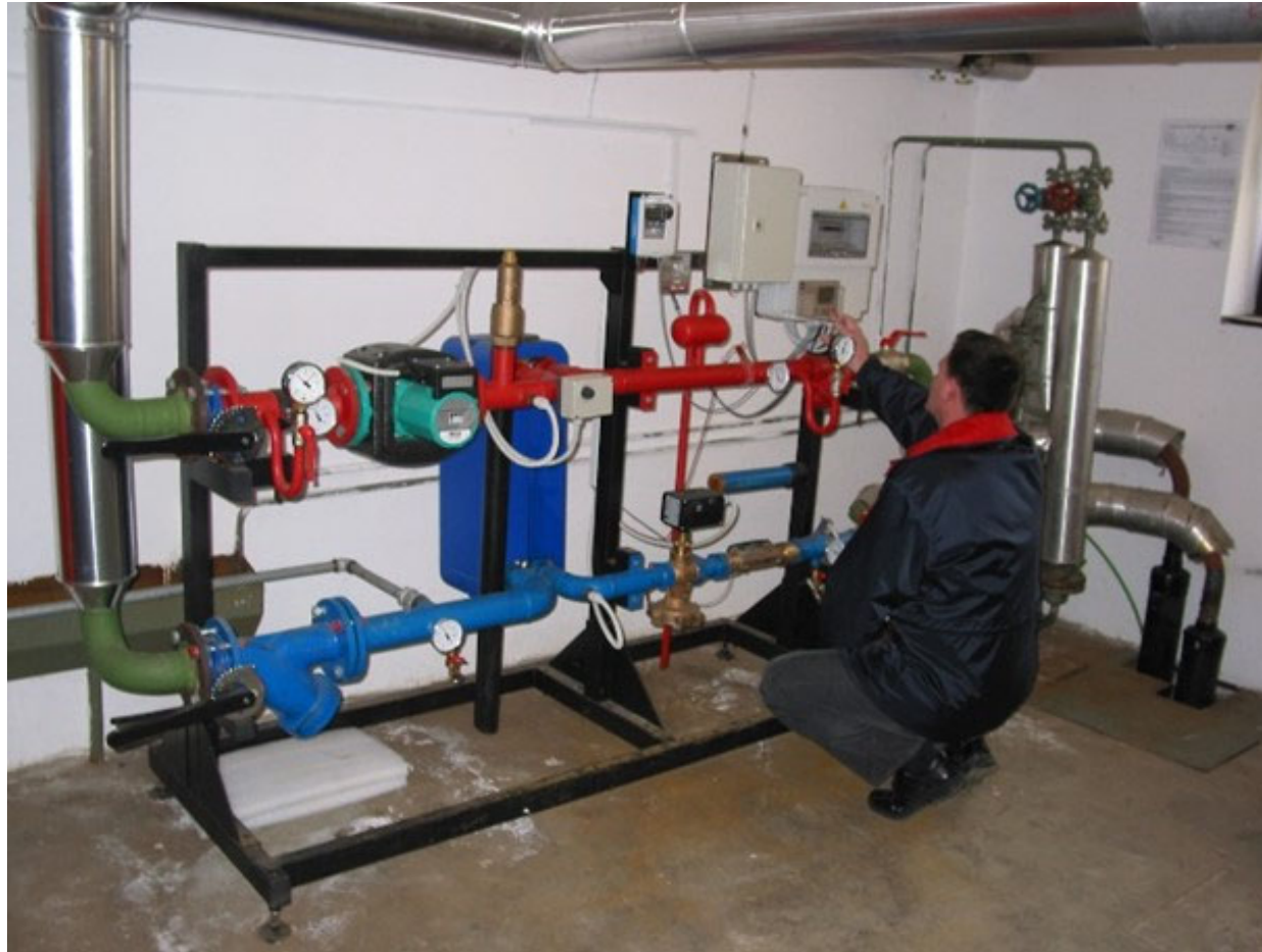
Slika 5: Kontrola delovanja indirektna toplotne postaje
